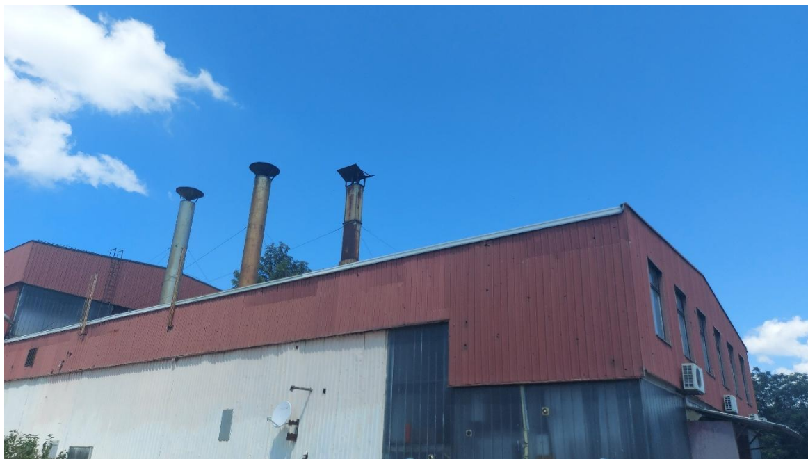
Slika 4. Dimnjaci na kotlovnici
