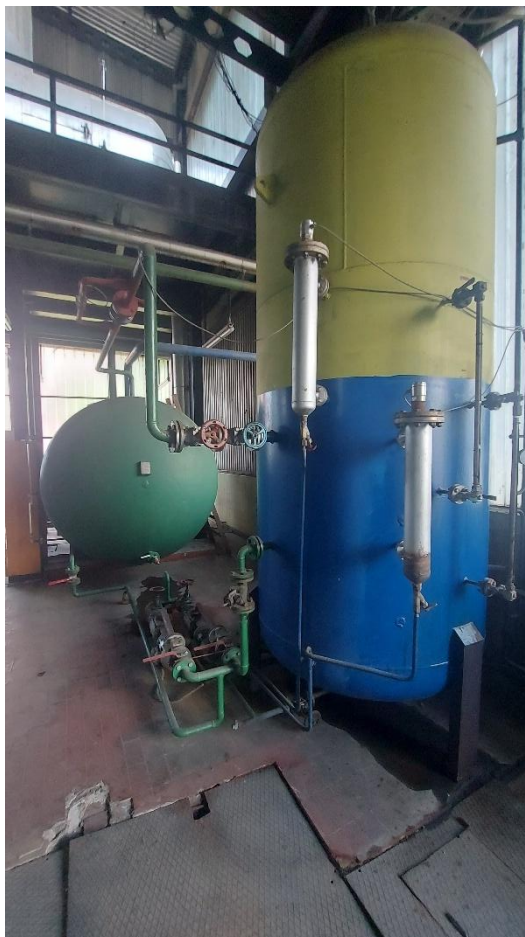
Slika 8. Ekspanziona posuda vrelovoda
