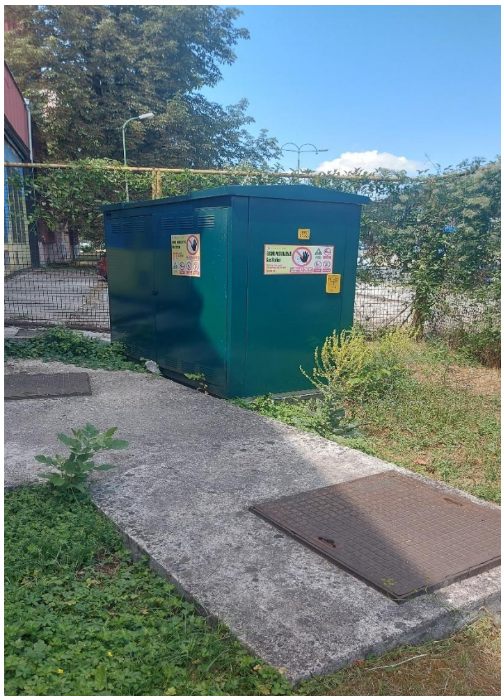
Slika 11. Redukciona plinska stanica
