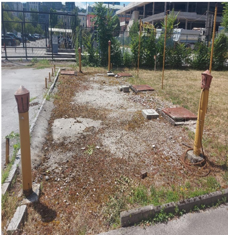
Slika 10. Šahтови od tri podzemna spremnika mazuta (3x100 t)
